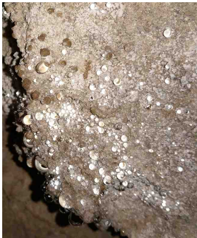
Figure 5 : Gouttes visibles en de nombreux endroits sur les parois du Toboggan
